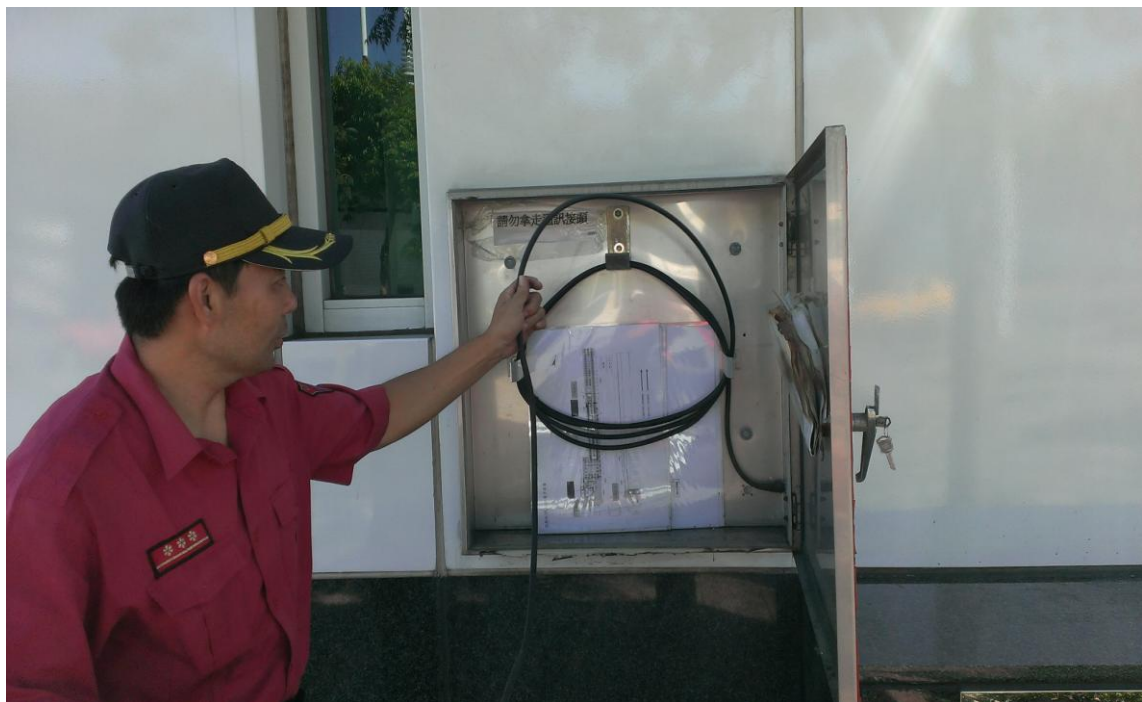
圖 4-5 高雄捷運消防無線電界面箱 (二)
