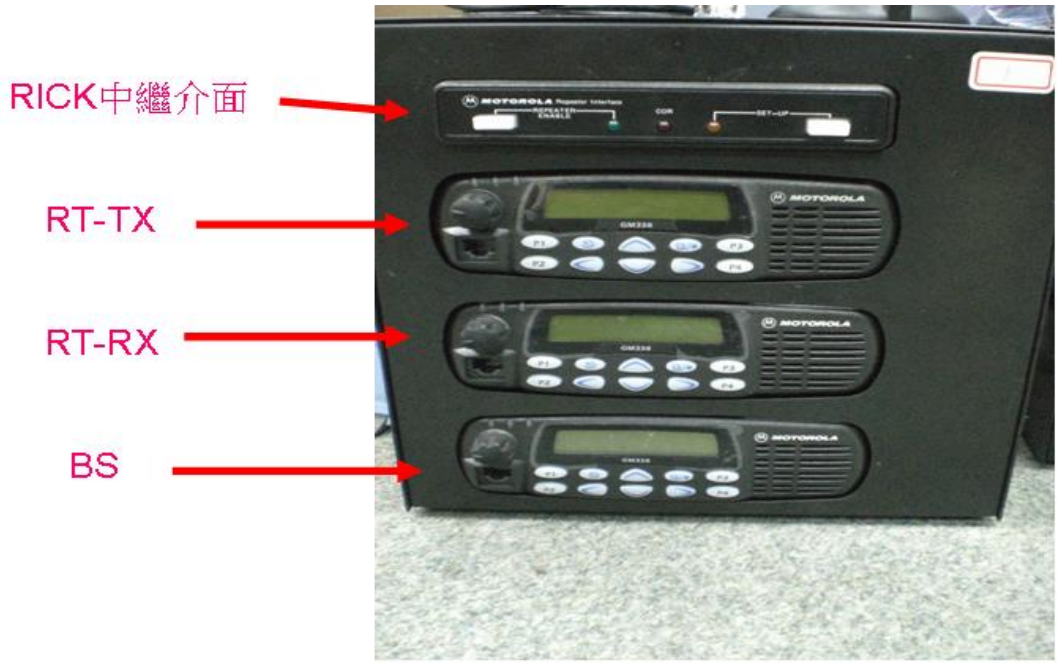
圖 4-2 高雄捷運移動式無線電轉播機 (正面)
