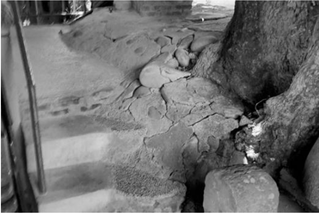
照 2-17 伯公溝伯公社樹破壞附屬設施狀況
