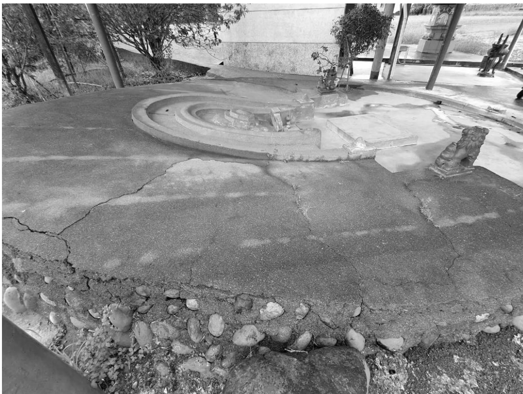
照 2-20 福德祠 (M064) 化胎處裂痕
