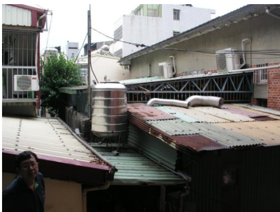
照片 7-2 北側增建屋頂整體外觀凌亂
