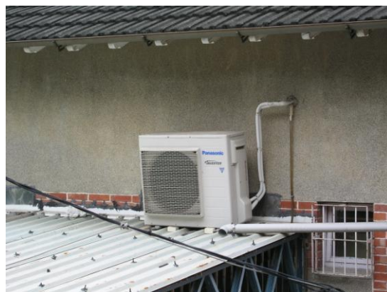
照片 7-3 冷氣的安裝影響立面景觀的視覺品質
